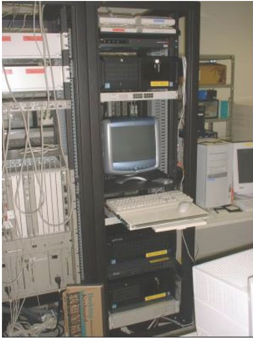
図1 サーバのラック収容状況
