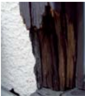
図1 壁際の腐朽例
