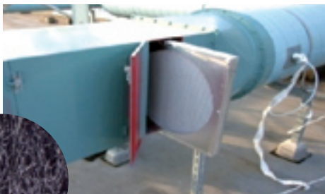
金属フィルターの利用例(排気ダクト)
