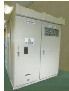
図1 キュービクルの例 変圧器、開閉器、電圧計などの計器類、過電流や地絡発生時に機器を保護する保護装置などが金属製の箱型容器に収められている。
